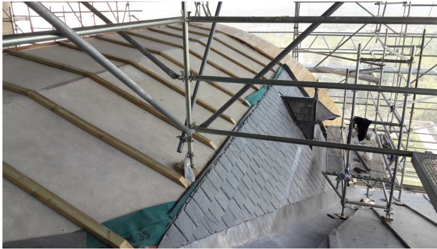
Renovación de las cubiertas del plomo en el Monasterio de San Lorenzo de El Escorial
