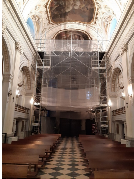
Ejecución de la consolidación de la bóveda y muro sureste de la Iglesia del Monasterio de la Encarnación
